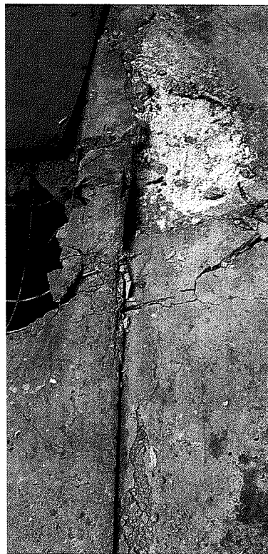
Figura 4 – Degradação do concreto. Fonte: Autor, 2021
