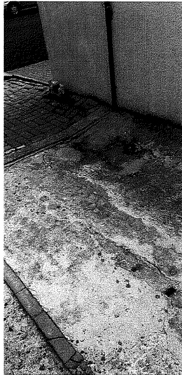
Figura 2 – Recalque de piso em concreto. Fonte: Autor, 2021
